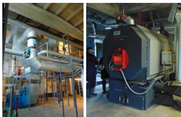
2.7. ATTĒLS: Šķeldas katls katlu mājā Bauskā (pa kreisi) un granulu katls katlu mājā Garozā (pa labi)
