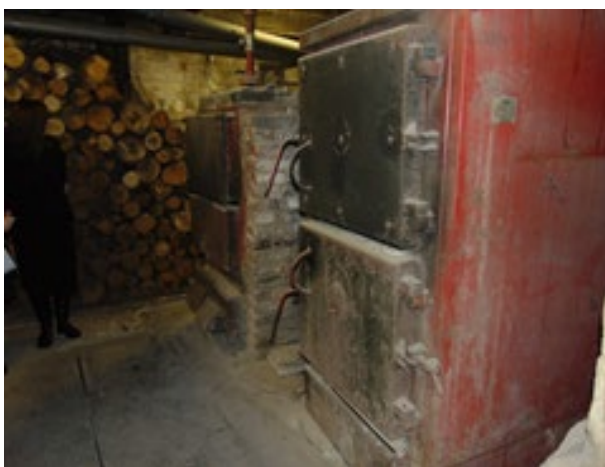
2.11. ATTĒLS: Dabas gāzes katli Uzvaras vidusskolā (pa kreisi) un Codes pamatskola ar malkas katlu māju (pa labi)
