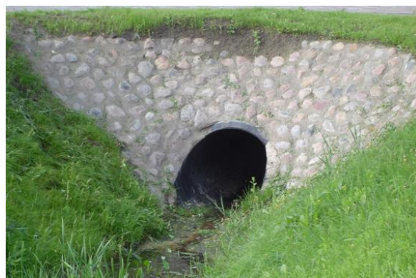
59. attēls. Caurteka Rīgas ielā, Jelgavā. Avots: autora arhīvs
