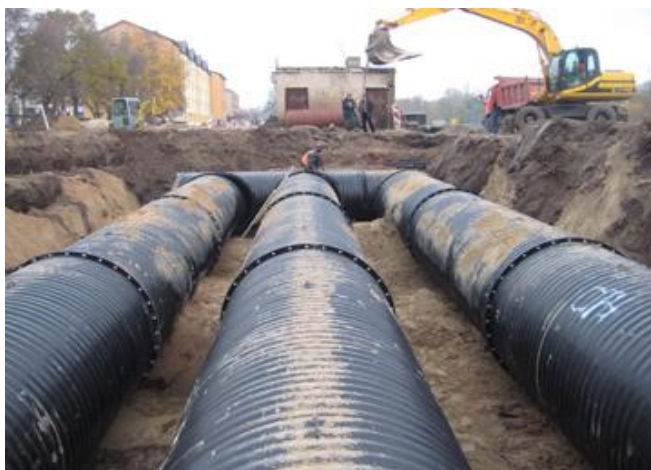
20. attēls. Raiņa ielas kolektora krājvertnes Jelgavā. Avots: autora arhīvs.
