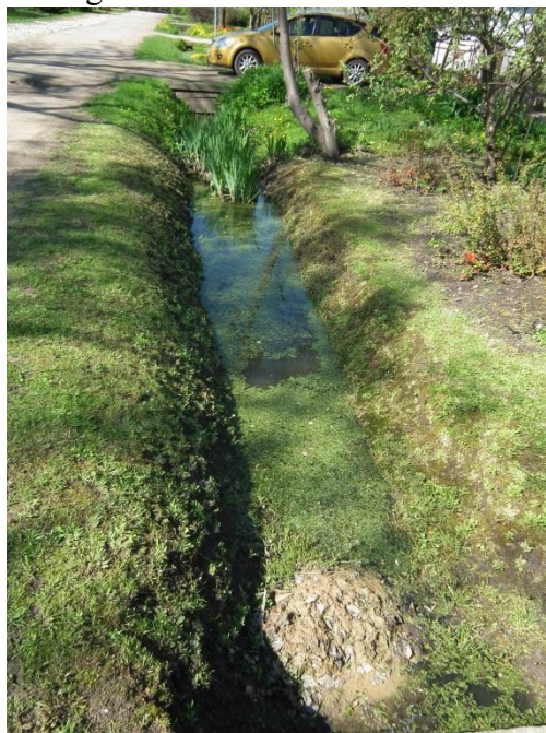
3. un 4. attēls. Problemātiskie novadgrāvji Bauskā. Avots: Bauskas novada dome.
