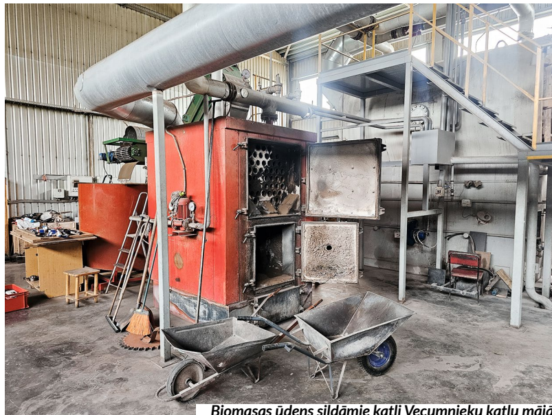
Biomasas ūdens sildāmie katli Vecumnieku katlu mājā.
