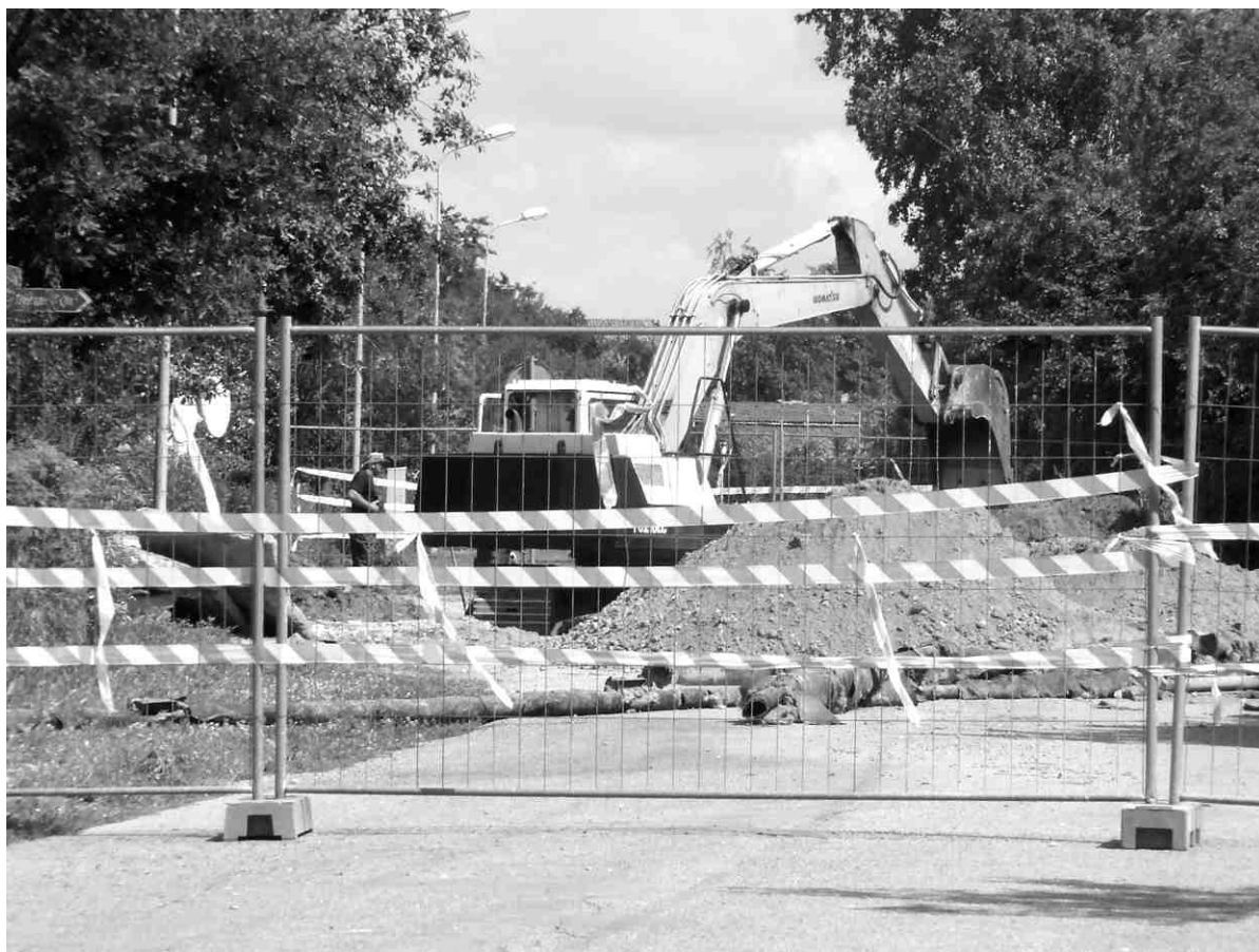
Kopš 8. jūlija Skolas un Dzirnavu ielas krustojums satiksmei ir slēgts. Līdz augusta vidum te veicami kanalizācijas cauruļvadu un aku darbības atjaunošanas darbi.
