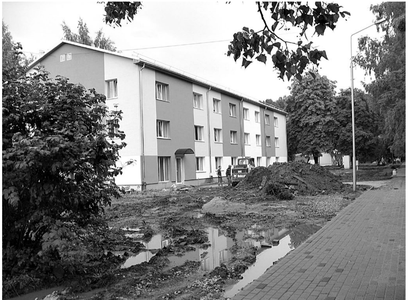
Kad pēc jūlija domes sēdes deputāti devās izbraukumā apskatīt Saulaines sociālo centru, darbi pie apkārtnes un telpu labiekārtošanas vēl ritēja pilnā sparā. Šomēnes bijušās dienesta viesnīcas ēkas rekonstrukcijas darbi tiks pilnībā pabeigti un iekārtotās dzīvojamās telpas jau drīzumā gaidīs savus iemītniekus. Plašāka informācija – 3.lpp.
